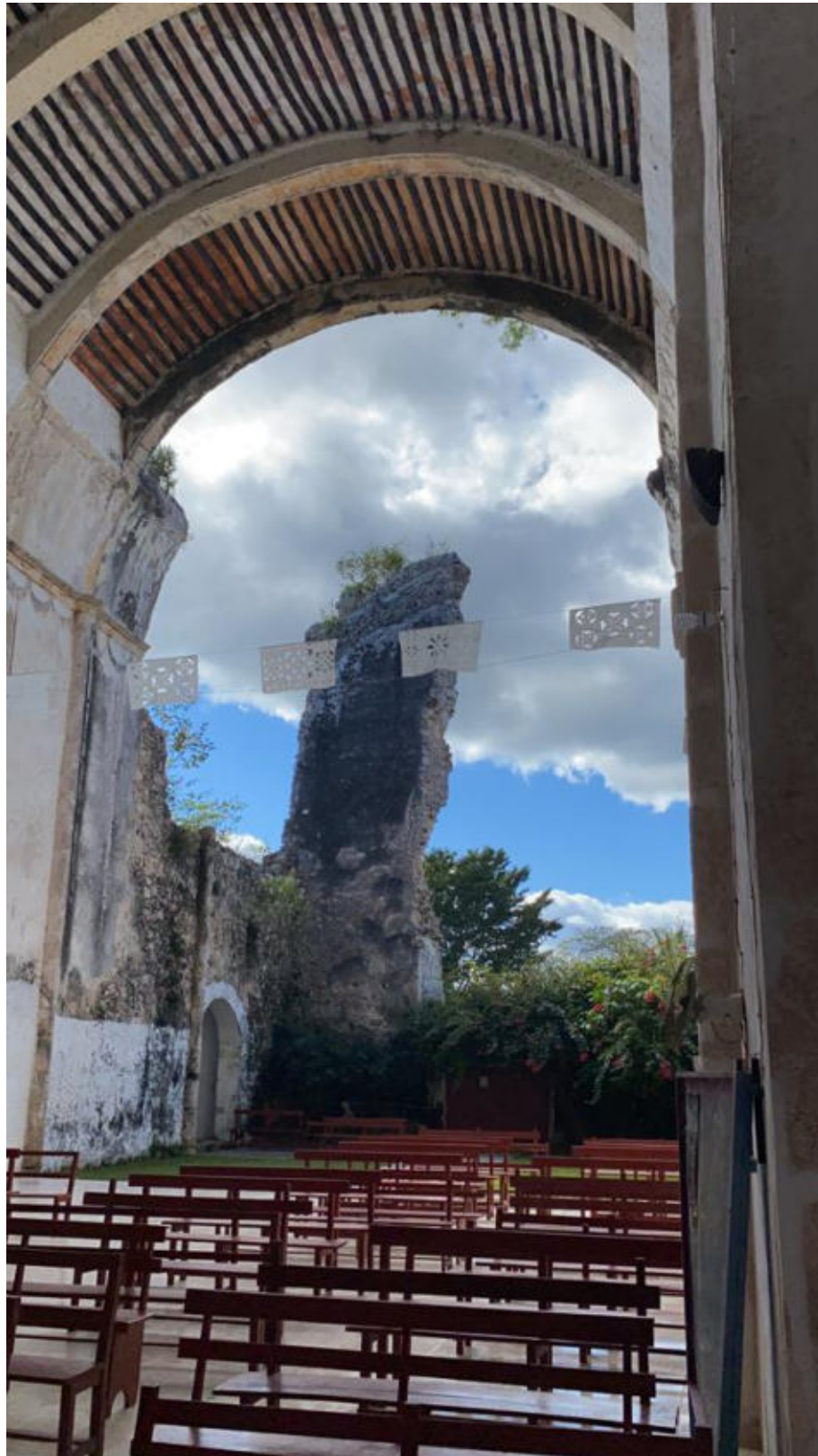
Figura 1. Imagen que muestra la parte posterior del Templo del Niño Jesús colapsada. Fecha de la fotografía: 2 de febrero de 2021.
